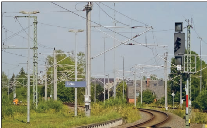
Elektrifizierte Strecke Chemnitz-Dresden Blick nach Chemnitz, Bild von 2020.
